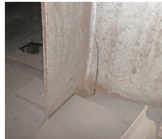
Фото 2 – Переход трещины с поясного листа на стенку колонны
