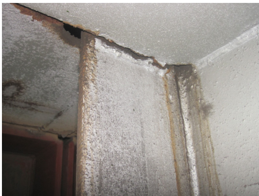
Фото 1 – Разрушение сварного углового шва крепления поперечного ребра жесткости к поясному листу колонны
